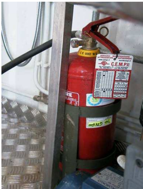
foto n. 20 - Estintore a polvere da 6 kg
