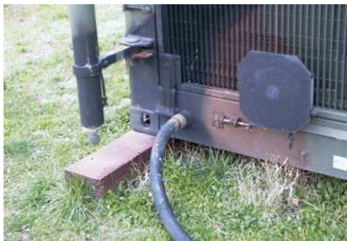
foto n. 8 - Bocchettone allacciamento acqua
