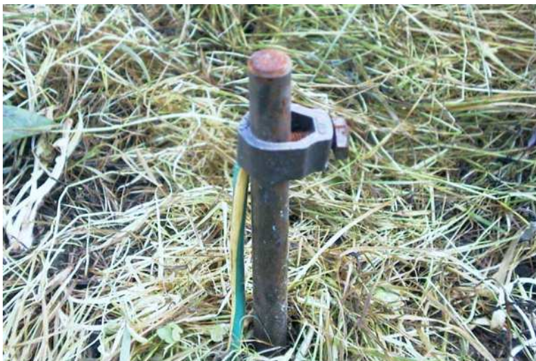
foto n. 14 – Dispersore di terra
