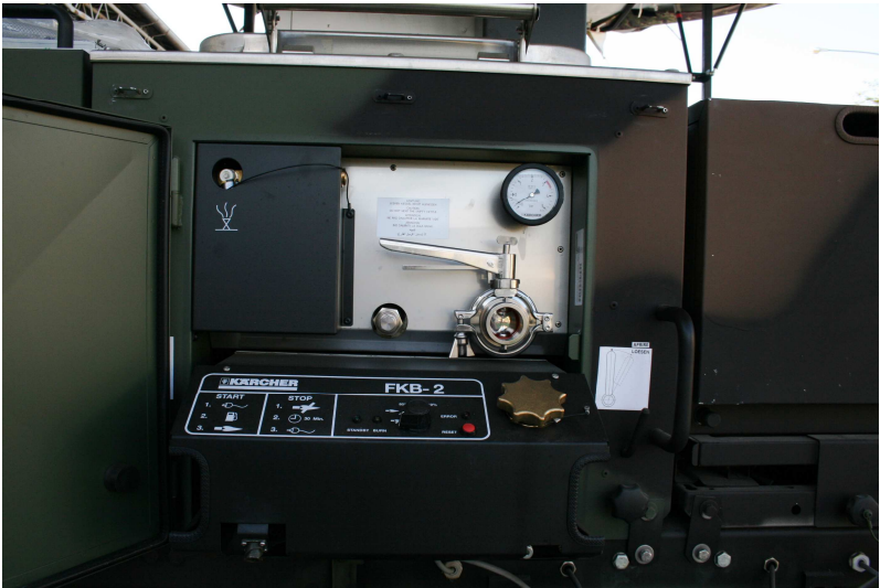
Dettaglio impianto idrico
