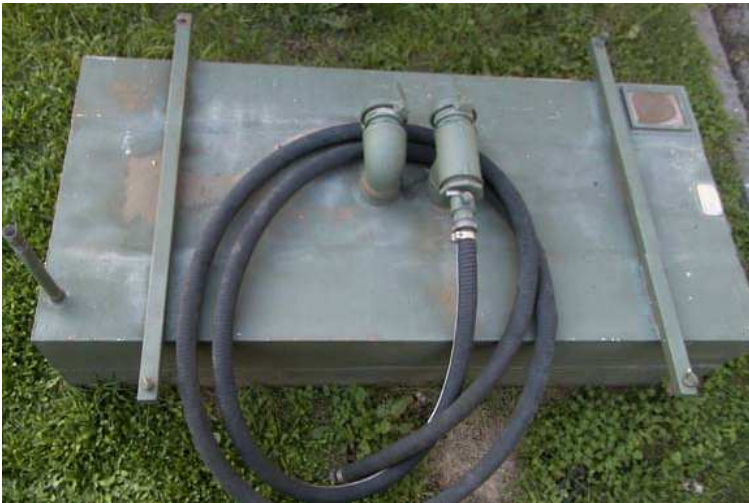
foto n. 11 - Cisterna per l'accumulo dei liquami
