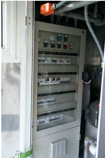
foto n. 13 - Quadro elettrico generale
