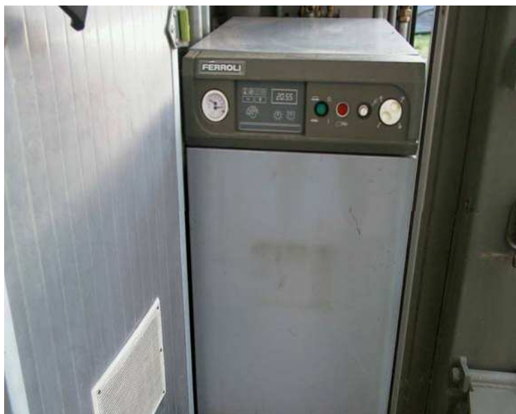
foto n. 10 - Generatore di calore a gasolio
