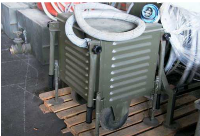
foto n. 11 - Autotrasformatore da 60 kVA
