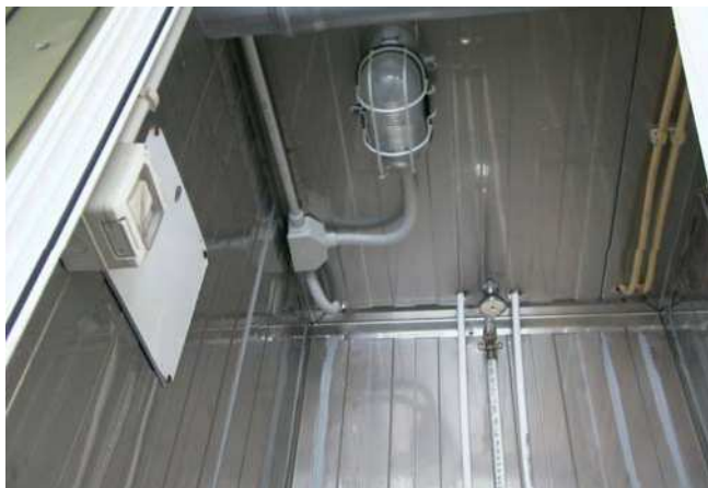
foto n. 12 – Illuminazione cabina doccia
