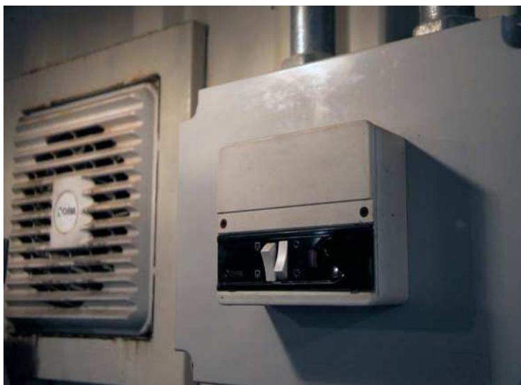
foto n. 17 - Elettroventilatore per l'estrazione dell'aria calda interna allo shelter
