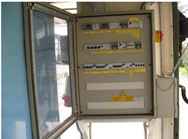
foto n. 10- Quadro elettrico di comando e controllo
