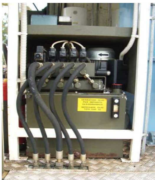
foto n. 9 - Centralina di sollevamento oleodinamica
