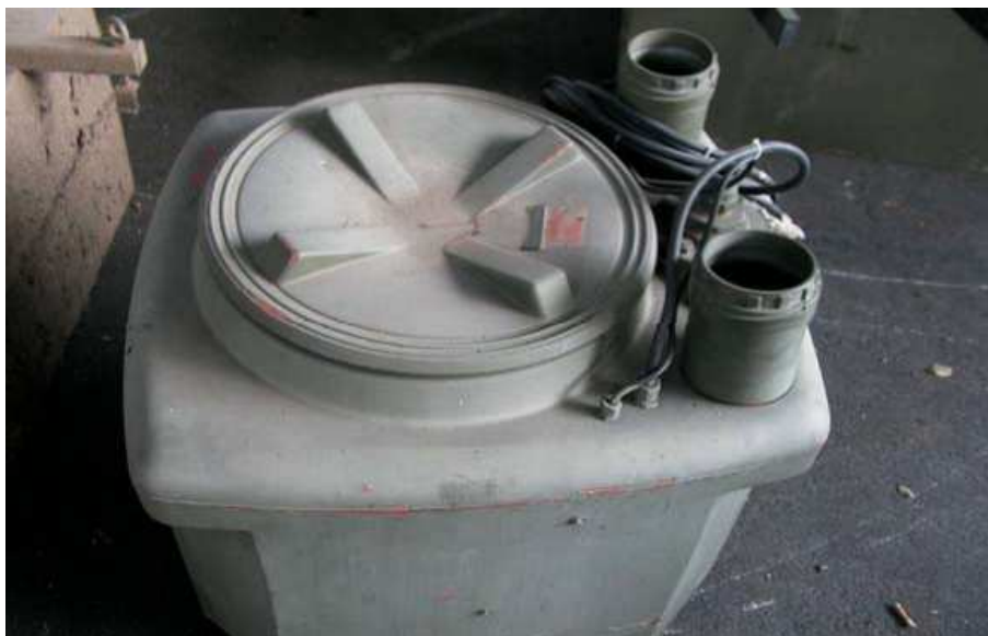
foto n. 12 - Stazione di sollevamento acque nere
