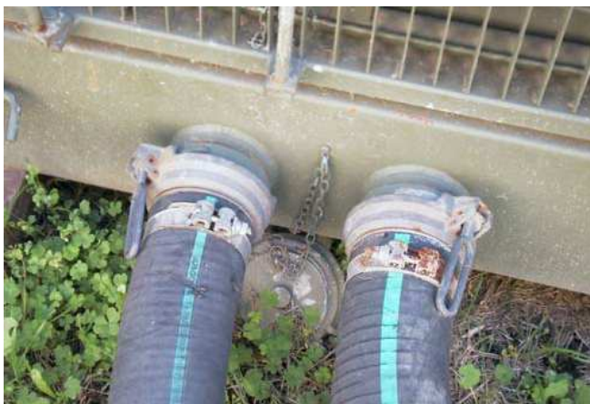
foto 8 - Scarico delle acque nere
