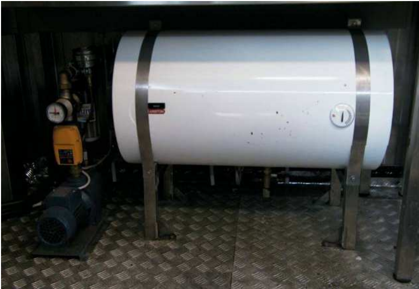
foto n. 17 – Boiler da 100 litri
