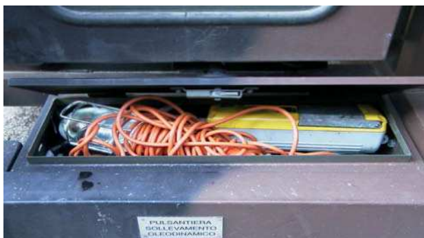
foto n. 11 – Pulsantiera comando impianto di sollevamento
