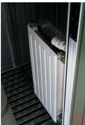
foto n. 2 - Impianto di riscaldamento a radiatori
