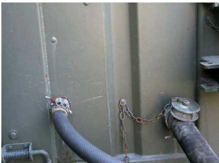
foto 26 – Bocchettoni carico/scarico acqua
