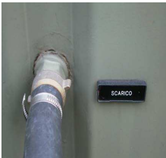
foto n. 9 – Bocchettone scarico acque reflue
