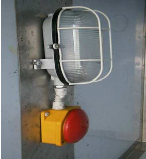
foto n. 14 – Pulsante di emergenza a fungo
