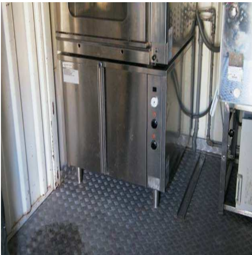
foto n. 11 - Cella di lievitazione elettrica
