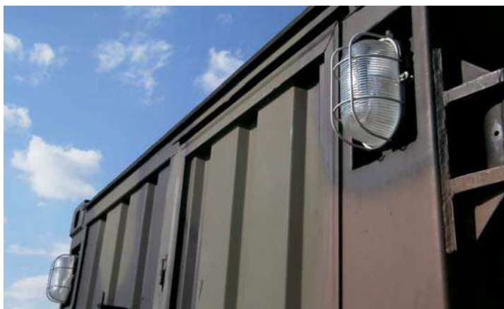
foto n. 1 – Impianto illuminazione esterna
