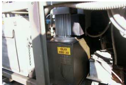
foto n. 11 – Pompa impianto di sollevamento
