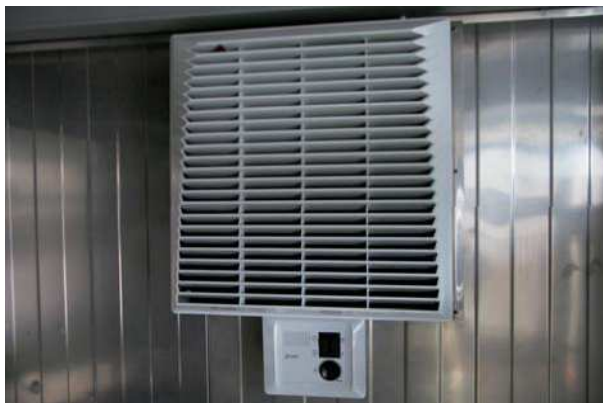
foto n. 3 – Aspiratore parete posteriore
