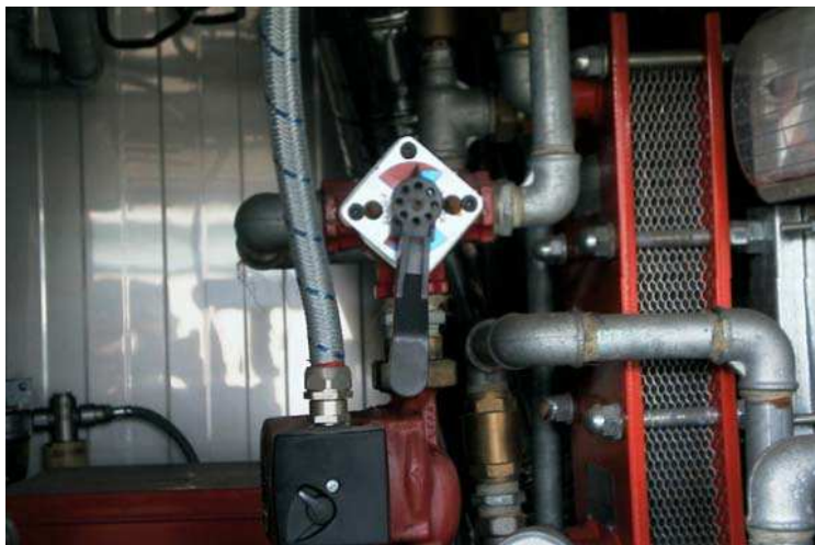
foto n. 14 - Dispositivo selezione funzionamento desiderato (ESTIVO o INVERNALE)
