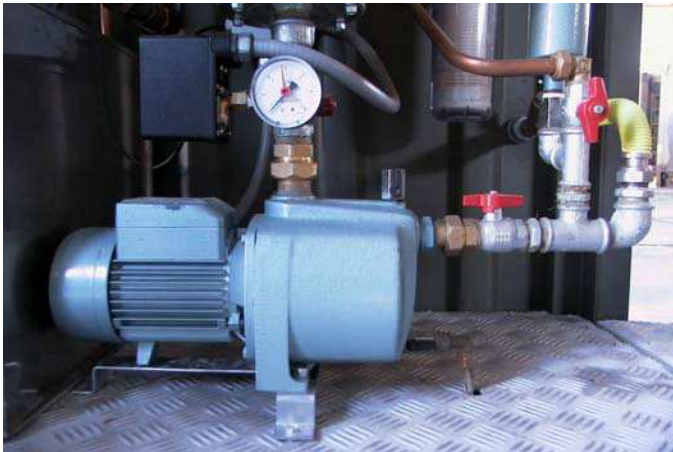
foto n. 9 - Elettropompa di alimentazione dell'acqua
