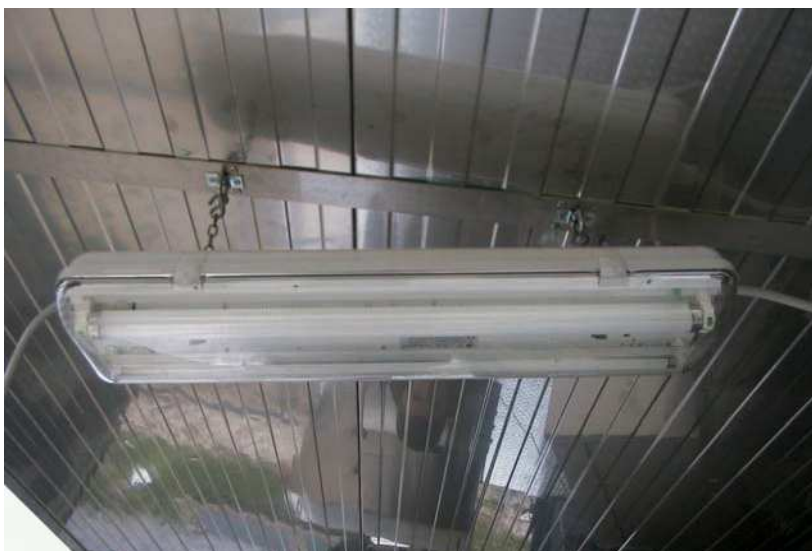
foto n. 13 – Particolare dell'impianto di illuminazione
