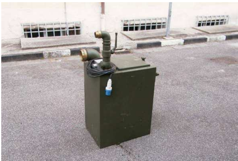
foto n. 15 - Stazione di sollevamento acque reflue
