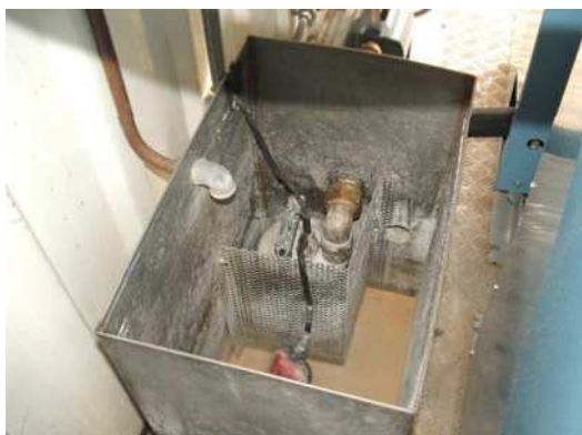
foto n. 8 - Vasca di raccolta acque reflue
