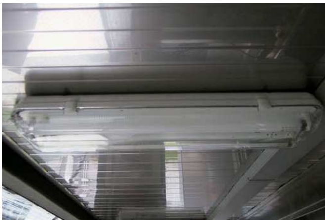
foto n. 4 – Plafoniera parete posteriore
