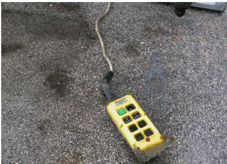
foto n. 5 – Pulsantiera di comando dell'impianto di sollevamento
