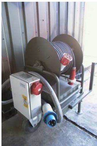
foto n. 10 - Carrello autotrasformatore ed aspo
