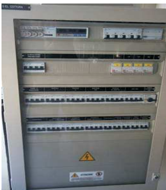
foto n. 7 – Quadro elettrico generale
